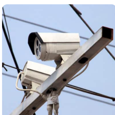
Блок контроля и управления
